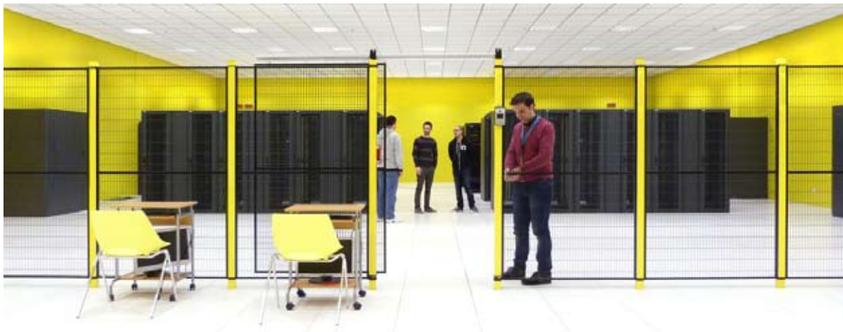
Misure di sicurezza interne al data center
